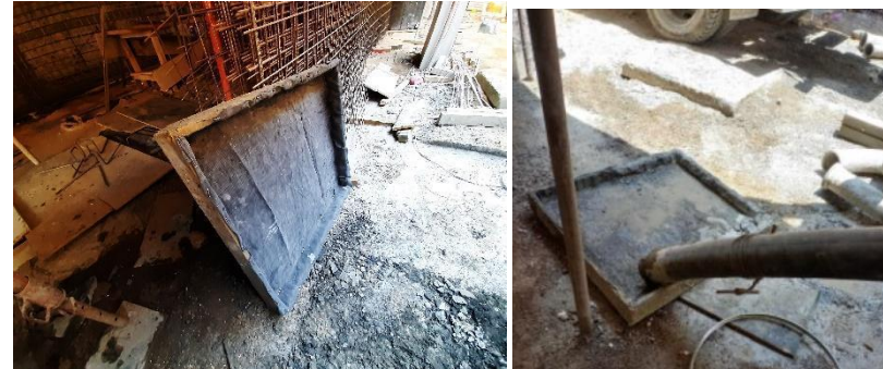
Figura 12: Pileta de lavado de concreto. Fuente: Registro fotográfico, Guatemala Green Building Council.
