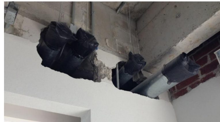
Figura 30: Protección de ductos de aire acondicionado. Fuente: Registro fotográfico, Guatemala Green Building Council
