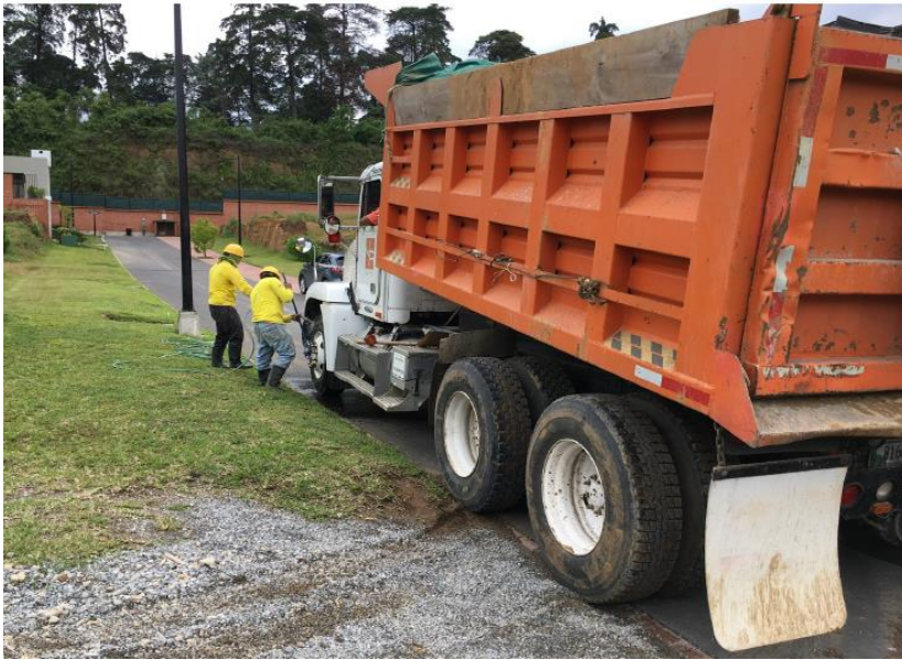
Figura 9: Pit de limpieza. Fuente: Registro fotográfico, Guatemala Green Building Council.
