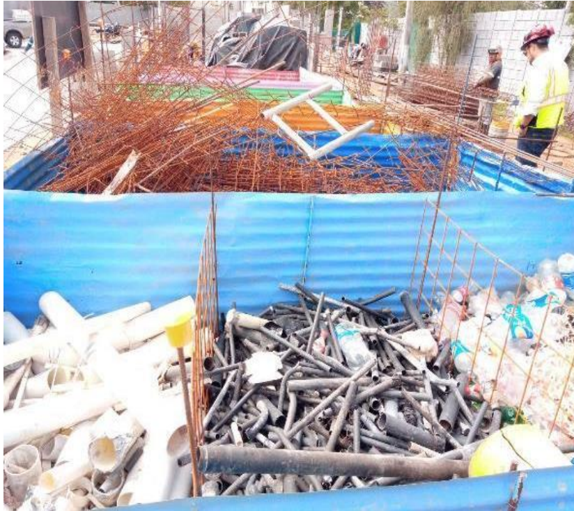
Figura 16: Ejemplo de área de clasificación de residuos de construcción, Fuente: Registro fotográfico Guatemala Green Building Council
